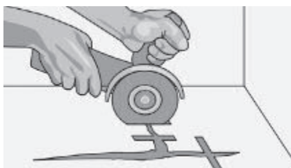
Рис. 3. При крупных трещинах, идущих по всей толщине бесшовного покрытия, необходимо сделать поперечные разрезы при помощи угловой шлифовальной машинки «болгарки». Глубина поперечных разрезов должна составлять до 2/3 от глубины основания. Данные разрезы наносятся на расстоянии приблизительно 25 см друг от друга
