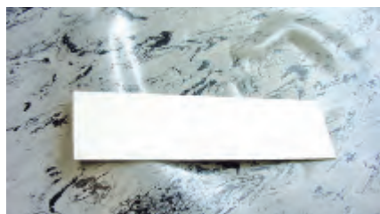
Рис. 11. Образование пузырей при несоблюдении требований по укладке
