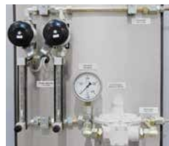
Система подачи негорючих защитных или реакционных газов
