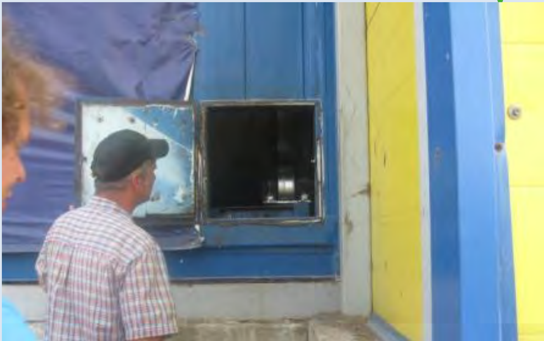
Контроль работы роликов привода барабана ФСУ.
