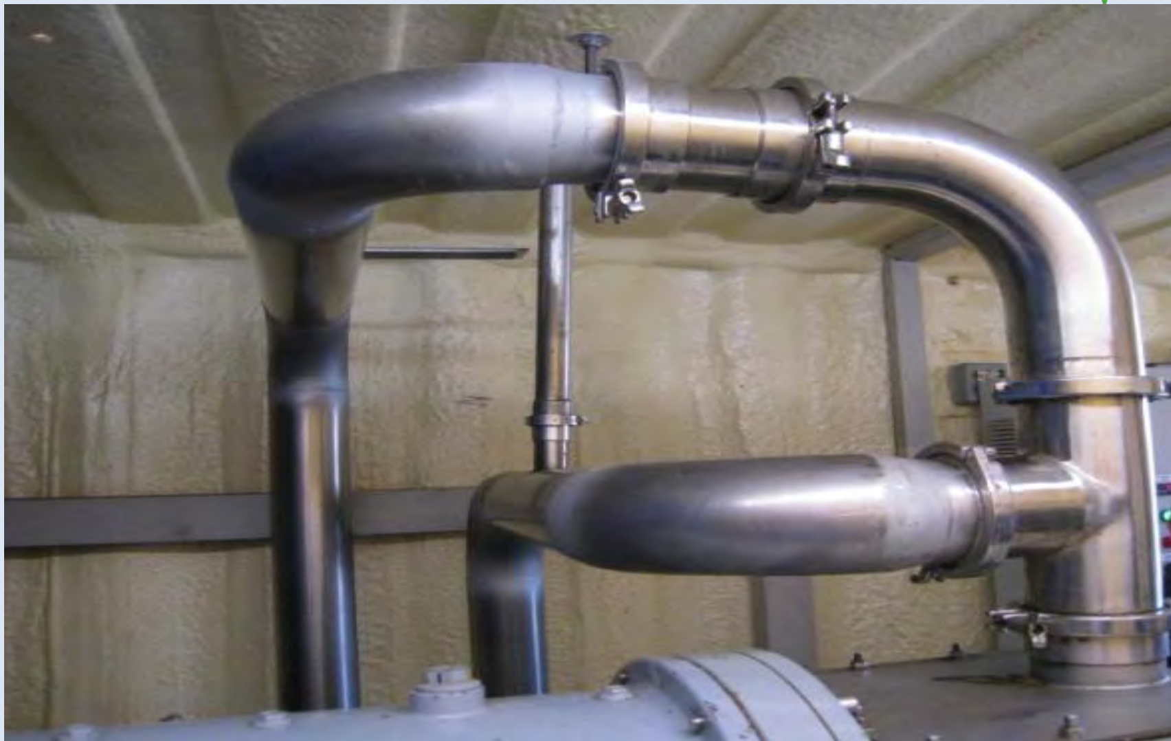
Сепаратор ФСУ с установленными трубопроводами.
