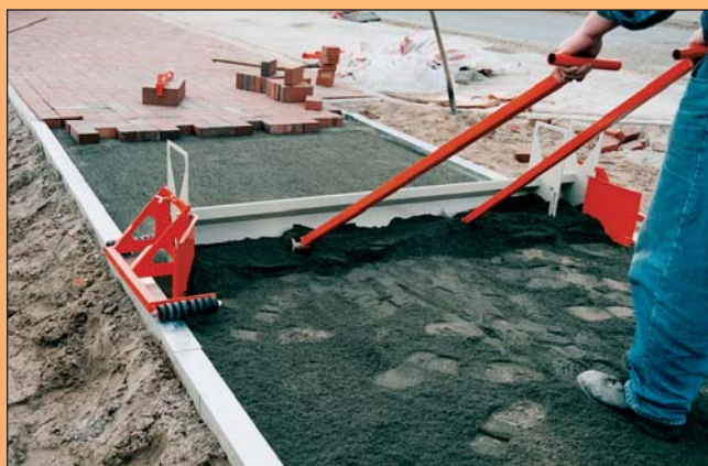
Ходовые механизмы катятся по бордюрным блокам. Боковые заслонки позволяют точную планировку и по краям.
