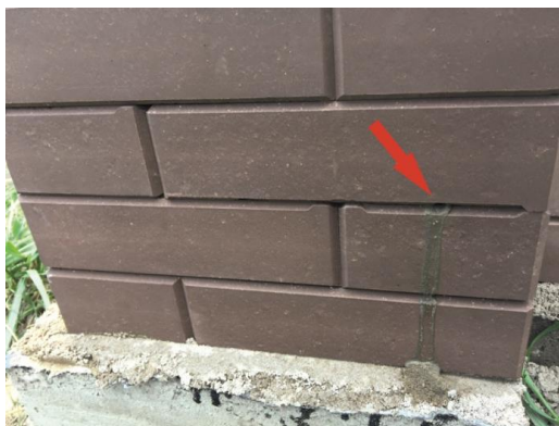
Рис 13. Подтек бетона после заливки, образовавшийся в результате неправильного монтажа столба (пазами наружу)
