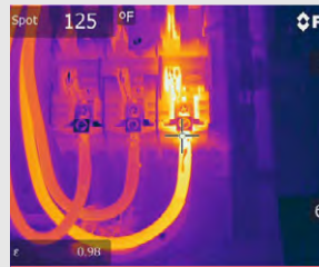
Перегрев кабелей и автоматических выкл.
