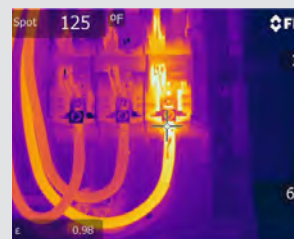
Перегрев кабелей и автоматических выкл.
