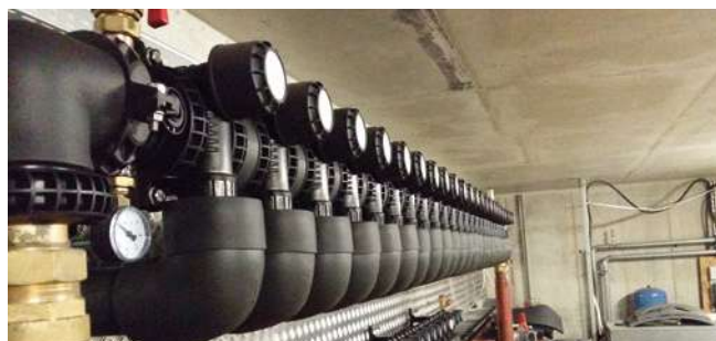
Фотография показывает 27-контурный коллектор ProCalida GT3 в системе грунтового теплообменника теплового насоса. Система находится в торговом центре Huta в местечке Węgierska Górka (Южная Польша).
