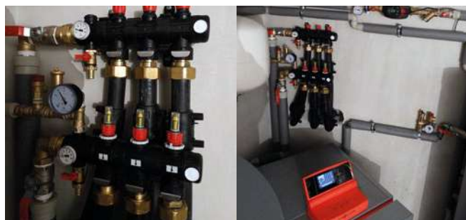
Фотографии показывают 3-контурный коллектор ProCalida IN в системе теплового насоса. Система находится в коттедже в местечке Turza Śląska (Южная Польша).
